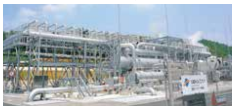
菅原バイナリー発電所 5,000kW (2015年6月運転開始)
