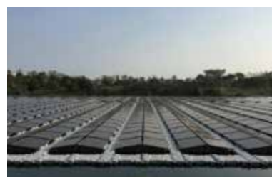
◇ スブ 樹谷第1～2発電所 5,130kW (2018年4月～運転開始)
