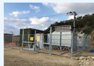
陸上電気設備
