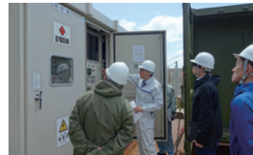
陸上電気設備
