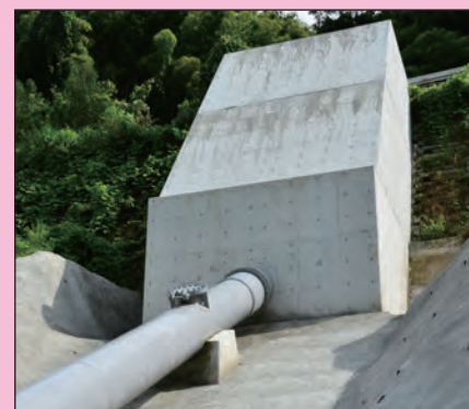
▲ パイプが動かないようにする設備
