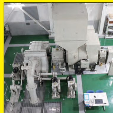
▲ 水車と発電機
