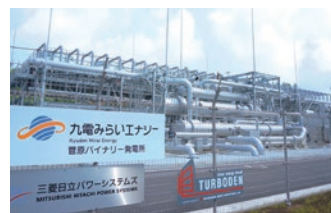
菅原バイナリー発電所
