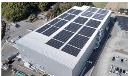
基山ソーラー発電所
