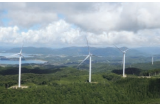
串間風力発電所
