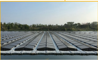
樹谷第1～2発電所 5,130kW (2018年4月～運転開始) 海外における水上太陽発電事業
