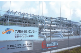
菅原バイナリー発電所
