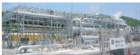
菅原バイナリー発電所 5,000kW (2015年6月運転開始)
