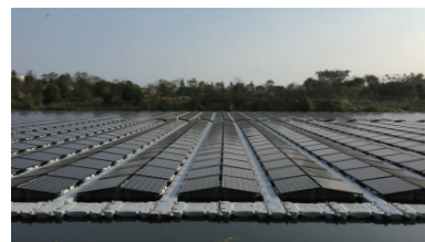
◇ スグ 樹谷第1～2発電所
