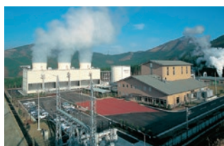
滝上発電所[大分] 27,500kW 運転開始時期/1996年
