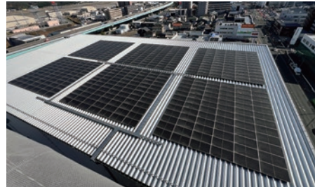
東那珂ソーラー発電所
