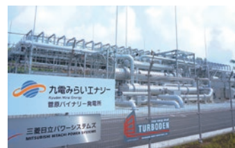
菅原バイナリー発電所
