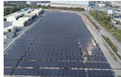
苅田ソーラー発電所
