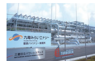
菅原バイナリー発電所
