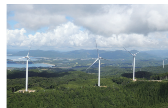
串間風力発電所
