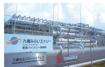
菅原バイナリー発電所
