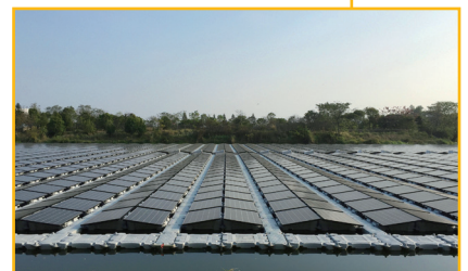
すぐ 樹谷第1～2発電所 5,130kW (2018年4月～運転開始) 海外における水上太陽発電事業
