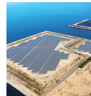
大村メガソーラー第1発電所
